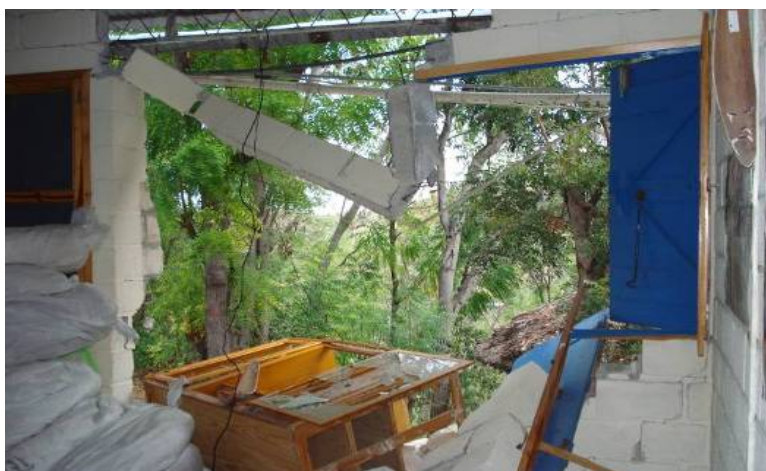
Les locaux d'ITECA après le séisme
